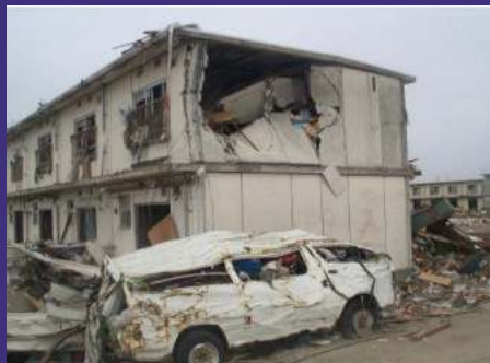
【漂流物衝突による外壁の損傷*1】
