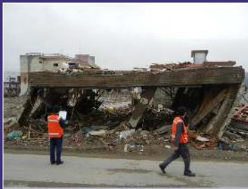
建築物の被害形態を調査
